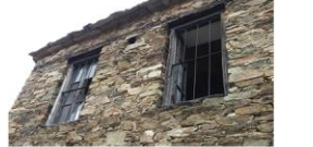
Προστατευτικές σιδερέιες ανοιγμάτων
